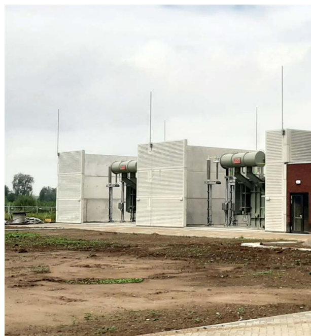
Transformatoren op elektriciteitsstation Zuilichem
