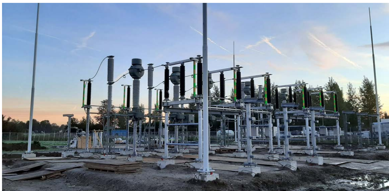
Nieuwe schakeltuin elektriciteitsstation Zuilichem
