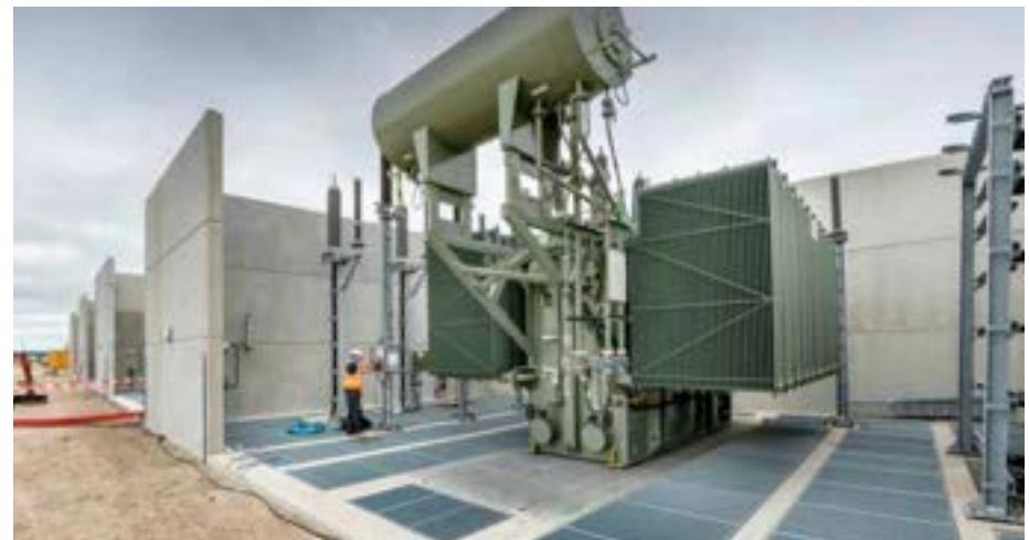
Referentiebeeld transformator in open ombouw van beton.
